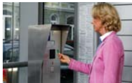
Per recuperare l'auto l'utente attiva la procedura di parcheggio tramite chip davanti al pannello di comando che, con l'utilizzo di un display, fornisce all'utente le istruzioni. Il personale via citofono gestisce il sistema di parcheggio 24 ore su 24.
