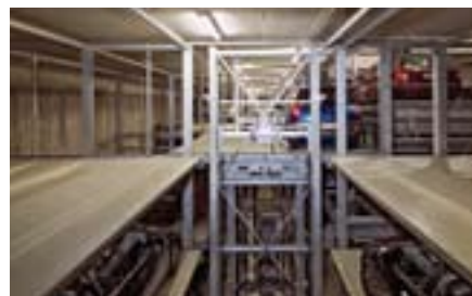
Mentre l'auto viene portata al livello inferiore dall'ascensore, l'unità di deposito si avvicina a questo, i due pallet si uniscono.
