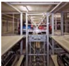
ed il pallet con l'auto viene traslato nell'unità di deposito e prelievo, posizionato e bloccato.
