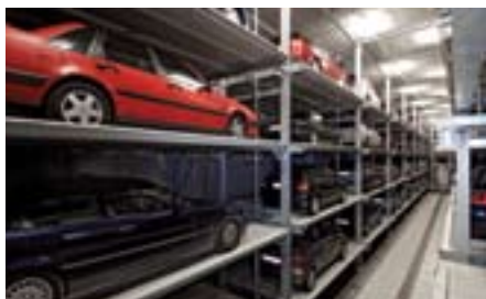
Un'immagine del Multiparker 740 con due file di pallet da entrambi i lati dell'unità di deposito e prelievo. Su quattro livelli sono parcheggiate 284 auto sotto la strada.
