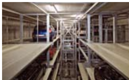
L'unità di deposito e prelievo muove il pallet con l'auto e lo trasporta attraverso i movimenti X, Y e Z allo spazio vuoto più vicino.
