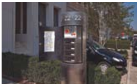
Il pannello di comando con pulsantiera è installato all'interno di un pilastro in acciaio in cui vi è anche il numero civico della casa e la cassetta per la posta. Il tutto per la comodità dell'utente.
