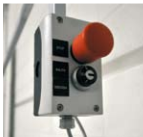
L'utilizzo dell'impianto è molto semplice e comodo: basta inserire la chiave codificata nel quadro di comando e sollevare o abbassare la piattaforma.
